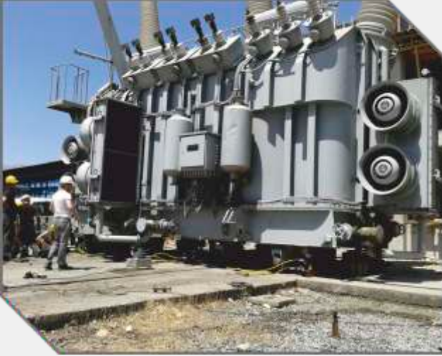
Substation Lifting Set / Trafo Kaldırma Seti
